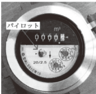
メータ内のパイロットで漏水の確認ができます
