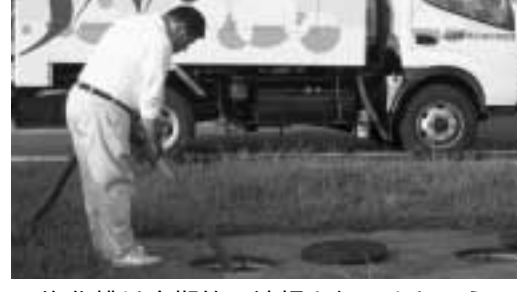
浄化槽は定期的に清掃を行いましょう
