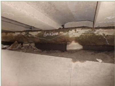
No.61 無名橋(82)【健全性Ⅲ】 （下部構造）剥離・鉄筋露出 海岸線距離 10.90 km
