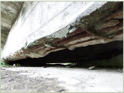
No.2 道塚橋【健全性Ⅲ】 （主桁）剥離・鉄筋露出 海岸線距離 12.00 km
