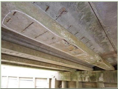
No.50 無名橋(21)【健全性Ⅲ】 （主桁）変形・欠損 海岸線距離 12.00 km
