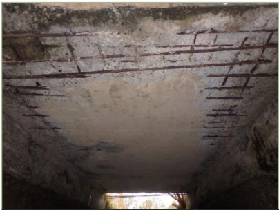
No.40 無名橋(90)【健全性Ⅲ】 （主桁）剥離・鉄筋露出 海岸線距離 9.20 km
