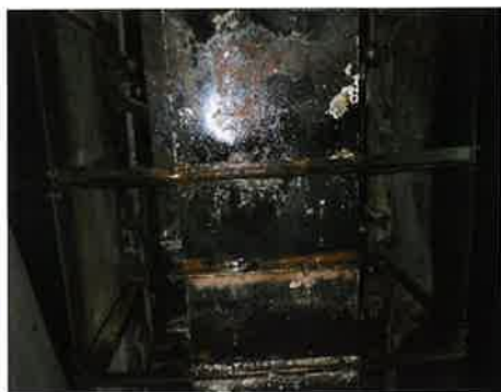
焼損した粗大ごみ処理施設内設備
